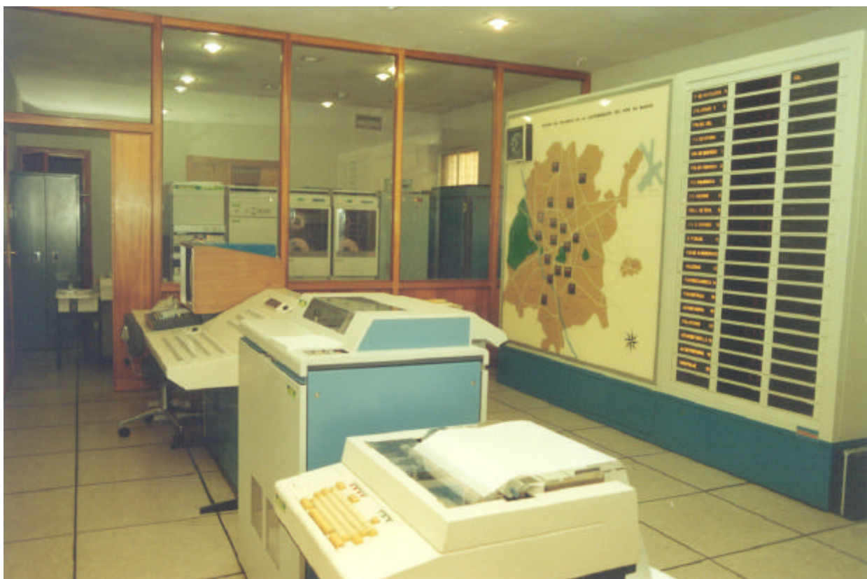
SALA DE CONTROL: PRIMERA RED (1978-1989)
